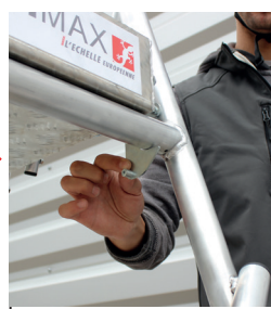
Vérifier que le crochet prenne bien le montant sous la plate-forme
